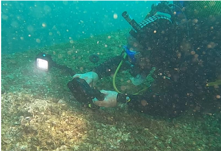
Şekil 8. Atatürk Barajı Betonarme bölgelerde zebra midye ( D. polymorpha ) kolonisi (Orijinal, 2024)
