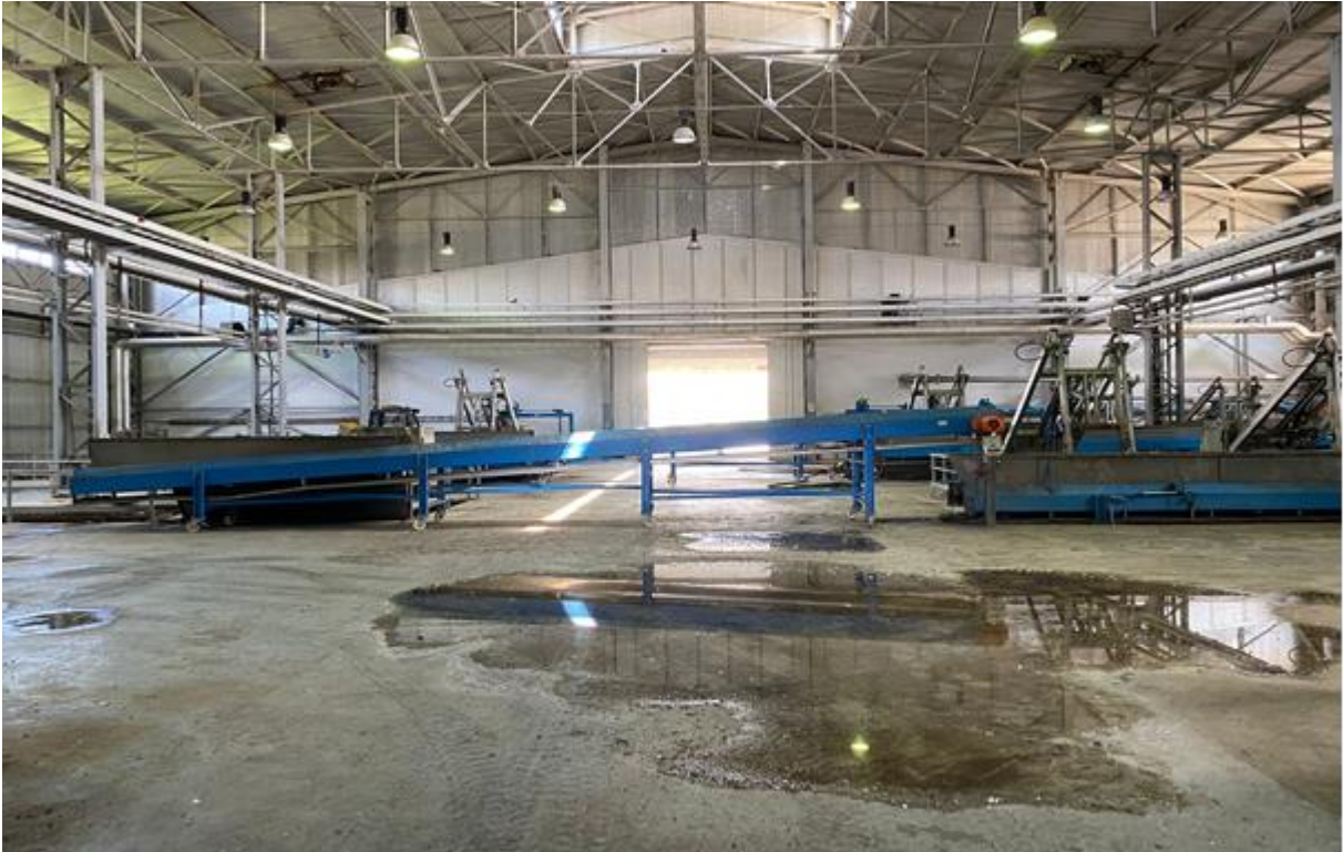
Resim 3. Ön arıtım ünitesi
