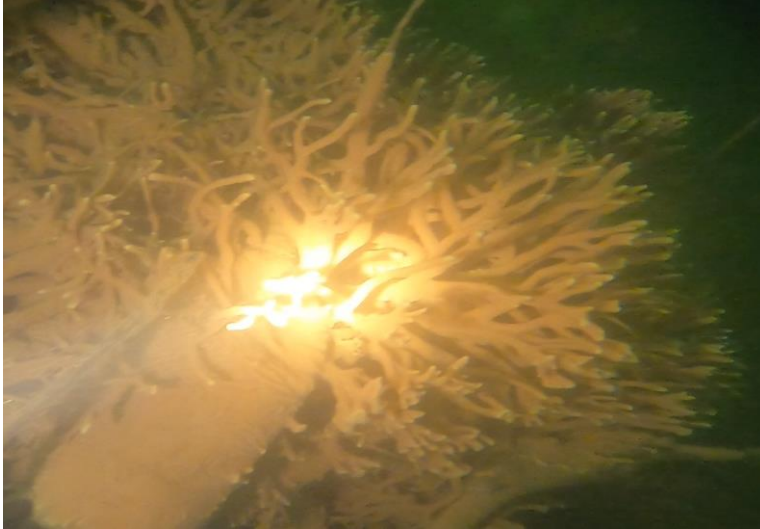
Şekil 10. Karkamış Barajı Betonarme bölgelerde tatlı su süngeri ( Spongilla lacustris ) kolonisi (Orijinal, 2024)
