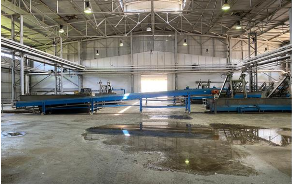
Resim 3. Ön arıtım ünitesi
